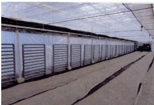
エコパイプ設置例
